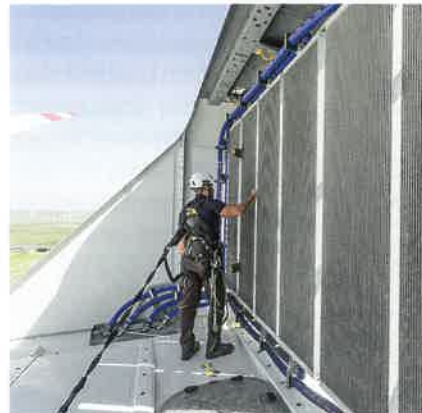
Die Getriebeölkühler sind hier auf dem Dach der Gondel. Thorben Baudewig sieht sich die Kühlrippen an.
